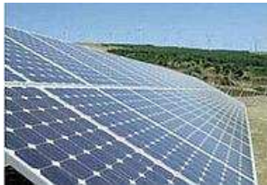
Un impianto fotovoltaico in Puglia
